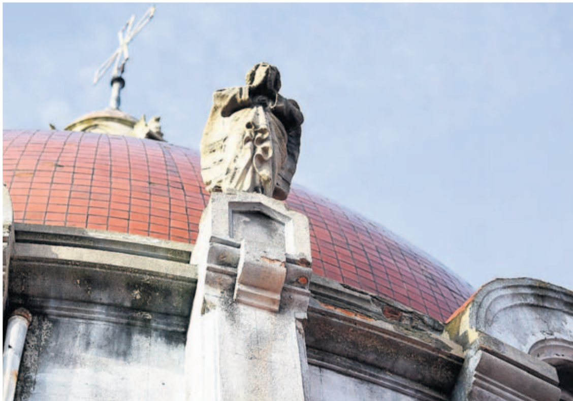
Elementos decorativos de San Juan, en los que se aprecian los recientes desprendimientos. | LAURA CARADUJE
